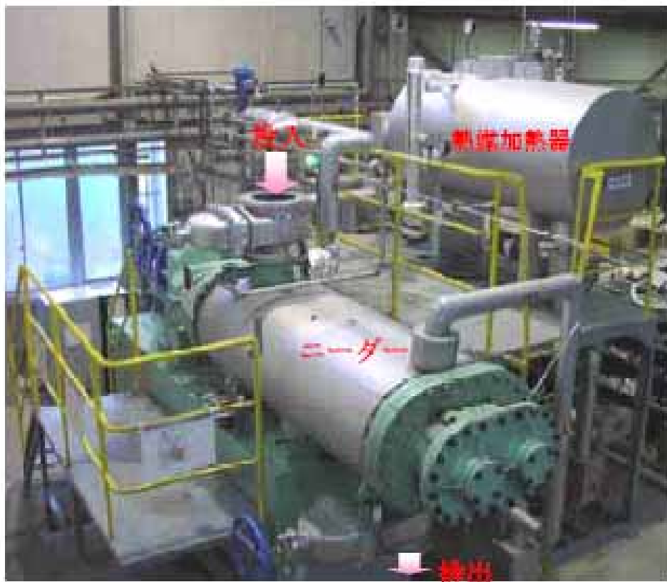
写真-1 実証プラント全景
