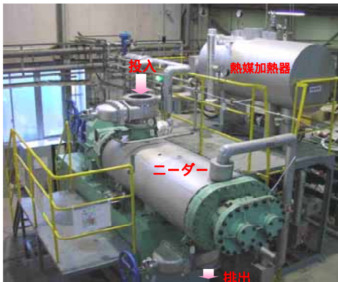
写真 - 1 実証プラント全景
