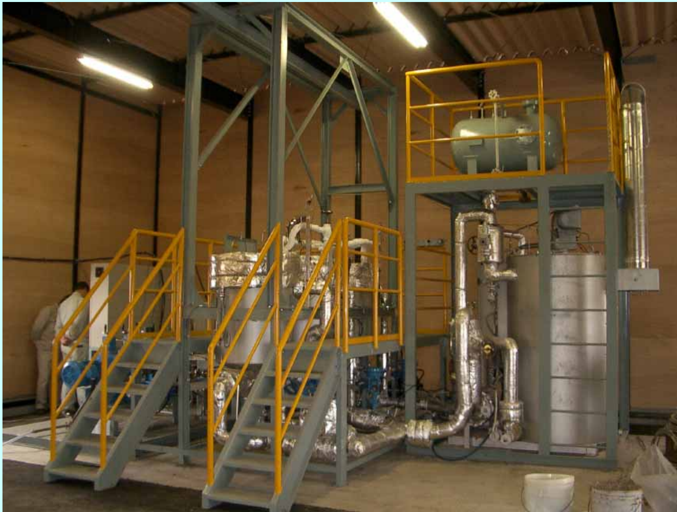
写真 予熱噴霧装置全景（前橋試験センター内）
