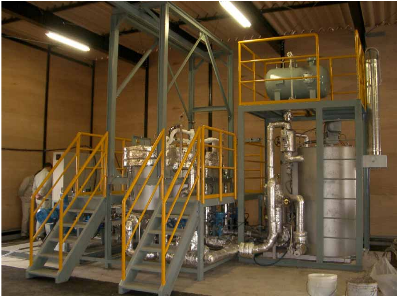
写真 噴霧装置全景(前橋試験センター内)
