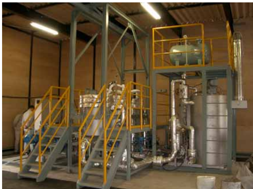
写真 3 スラリー予熱噴霧装置全景（前橋試験センター内）
